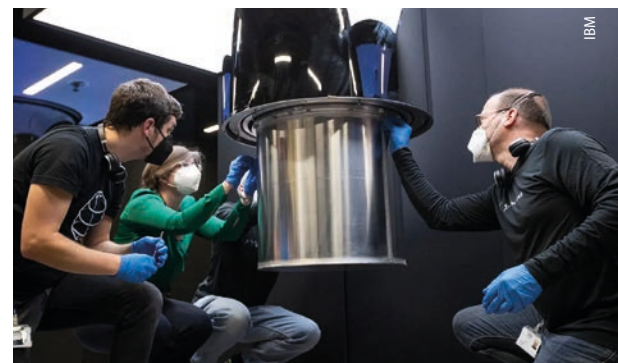
Die Montage des IBM Quantum System One gelang den deutschen IBM-Mitarbeiterinnen und -Mitarbeitern mit Fernunterstützung durch das Spezialteam in den USA.
