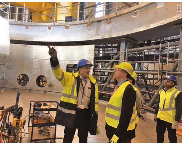
ITER-Generaldirektor Bernard Bigot (links) führt Anfang Dezember den amerikanischen Wissenschaftsstaatssekretär Paul Dabbar (DOE, vorne rechts) durch die Baustelle im südfranzösischen Cadarache.
