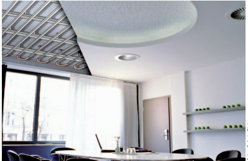
Kühldecken verstecken sich oftmals unter abgehängten Decken oder Panels
