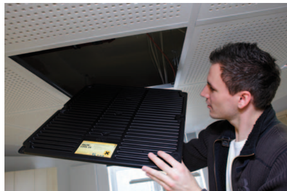
Abb. 2 Phasenwechselmaterialien lassen sich in eine Deckenabhangung integrieren. Hier kommen Salzhydrate mit einer Kristallisationstemperatur von 22 °C zum Einsatz.
